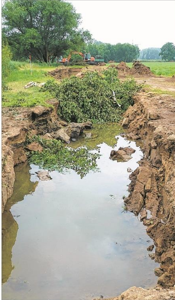
Frisch ausgebaggert ist dieser Teil des zukünftigen Biotops. Die Auenlandschaft wird in mehreren Abschnitten wiederhergestellt. Fotos: Ursula Holtgrewe
